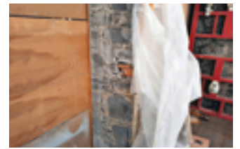
3) Pour créer la cage d'ascenseur, il faut scier le mur en moellons du musée. L'ouverture est prête pour que l'on puisse accéder aux étages. Für den Bau des Aufzugschachts muss die Bruchsteinmauer des Museums aufgesägt werden. Die Öffnung für den Zugang zu den oberen Stockwerken ist bereits geschaffen.
